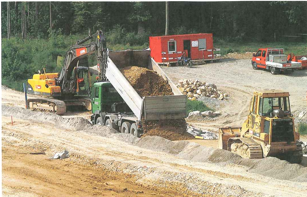
Rund 36 000 m 3 Material sind für den Dammbau zu schütten. Der Damm besteht aus einem wasserdichten Kern von zum Teil lokal anfallendem Lösslehm und einem Stützkörper aus zugeführtem Kies. (Fotos: ra)
